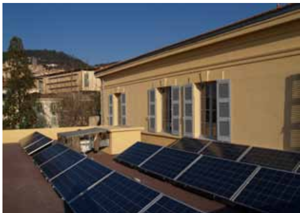
Panneaux Solaires Pôle Azur Provence
